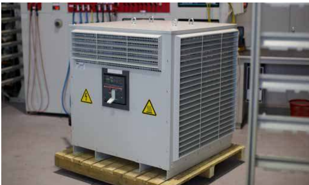
Autotrasformatore da 800kVA con interruttore da 1600A
